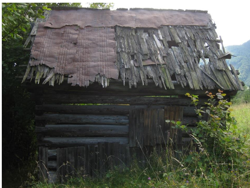
Obr. č. 5 Stav väčšiny senníkov pred opravou (foto Boris Hochel)
