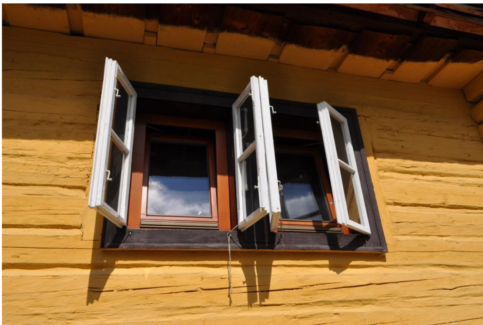
Obr. č. 15 Novodobé rušivé okenné výplne (foto M. Dudáš)
